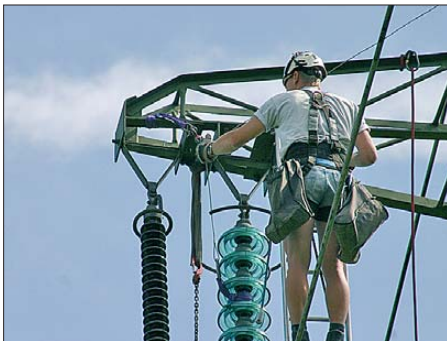
Bild 10: Austausch der Glaskappenisolatoren
