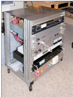
Die Sende- und Empfangstechnik-Einschübe bei DB0HDF
